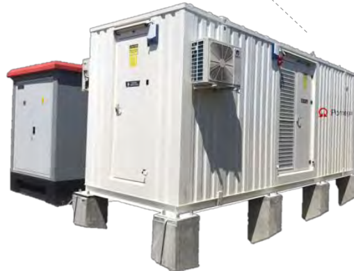
Enerji Depolama Sistemi
