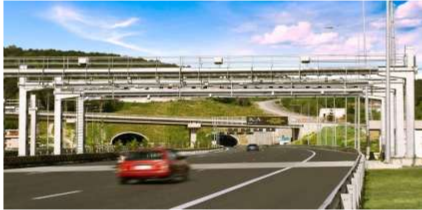
Çok Şeritli Serbest Geçiş Ücret Toplama Sistemi
