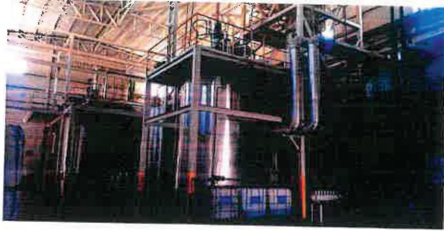
Şekil: Plastifiyan İşletmesi
